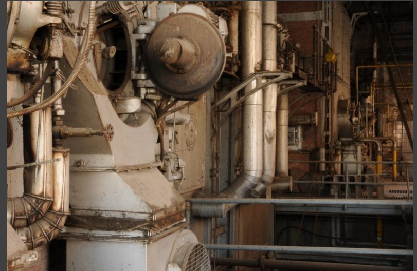
Fabra i Coats Sistema energètic
