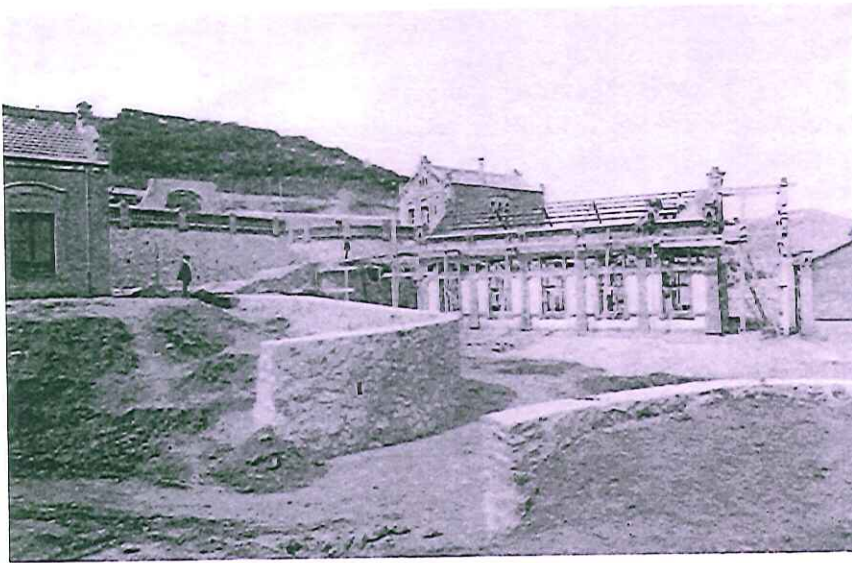
Estació elevadora de Trinitat Vella en construcció el 1917. A l'esquerra es pot veure una part de l'edifici destinat a oficines i magatzem; al centre, la sala que havia d'allotjar les tres electrobombes elevadores; a la dreta, es contempla parcialment la sala de distribució, i, al fons, la casa del guarda, al costat de l'entrada del recinte, a tocar de la carretera de Ribes. Ajuntament de Barcelona, 1917. Gaceta Municipal de Barcelona, АНСВ.
