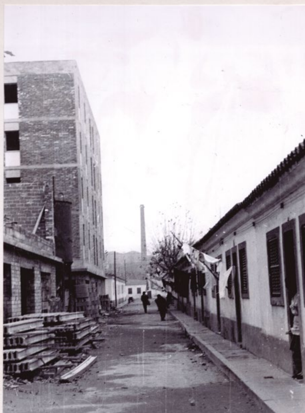
ESTADO COMPARATIVO DE LOS BLOQUES N.º. 1 Y 2 UN AÑO DESPUES DE DAR COMIENZO A LAS OBRAS.
